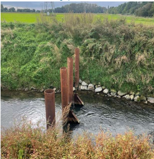
Figuur 3-5 Houtvang direct bovenstrooms van de sifon.
