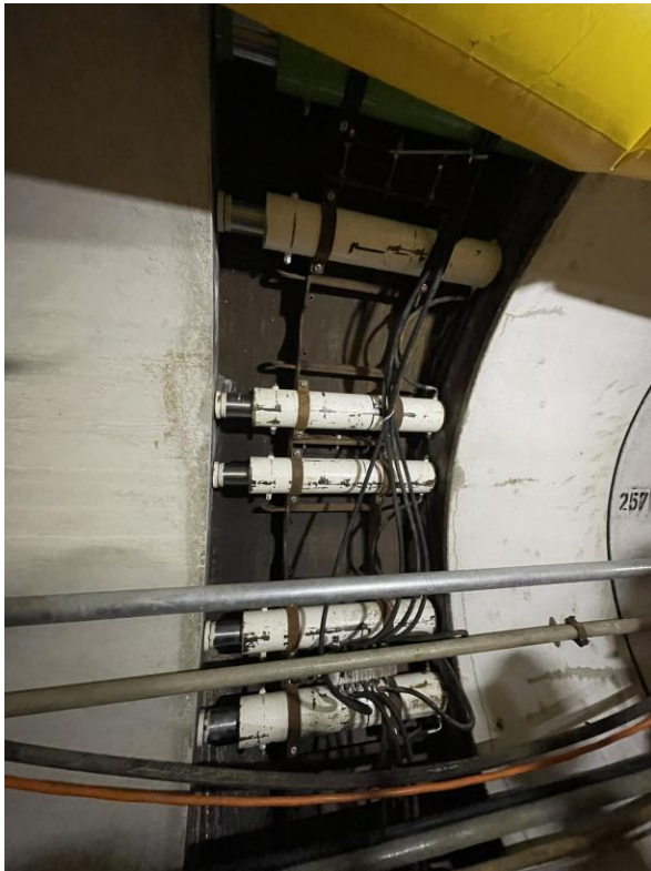
Afbeelding 11.27 tussendrukstation Ecluse II
